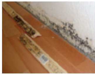
Hinter Fußleisten tritt häufig Schimmelpilzbefall auf.
