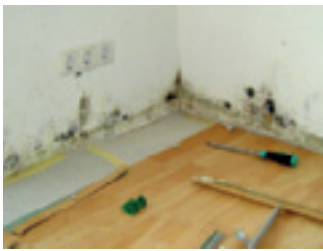
Außenecken sind typische Bereiche von Pilzbefall.
