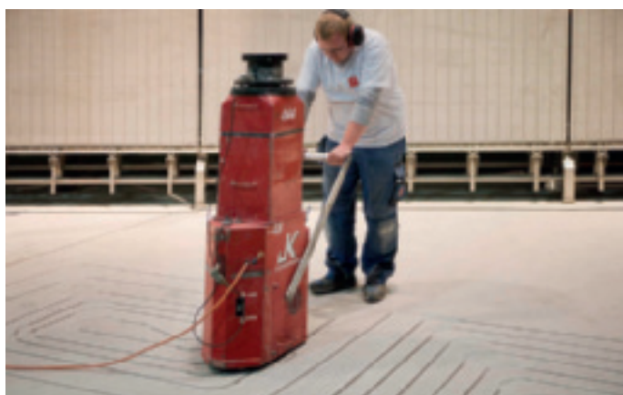
Die Elemente des wurden mit Nut- und Federprofil zu einer planen Ebene verlegt und vor Ort für das Heiz- und Kühlsystem gefräst.
