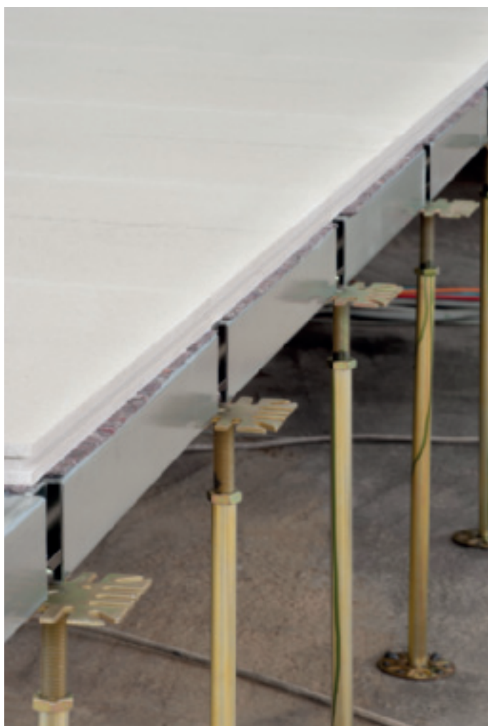
Etwa 3.000 individuell justierbare Hohlbodenstützen brachten den Flächenhohlboden auf eine Höhe von 80 bis 100 cm.
